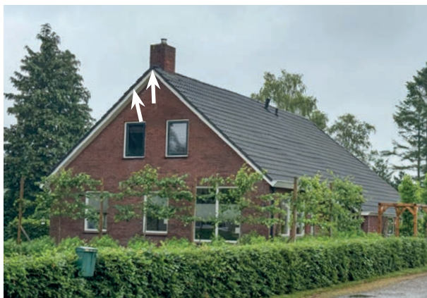
Figuur 13. Invliegopeningen, woning noordzijde.
