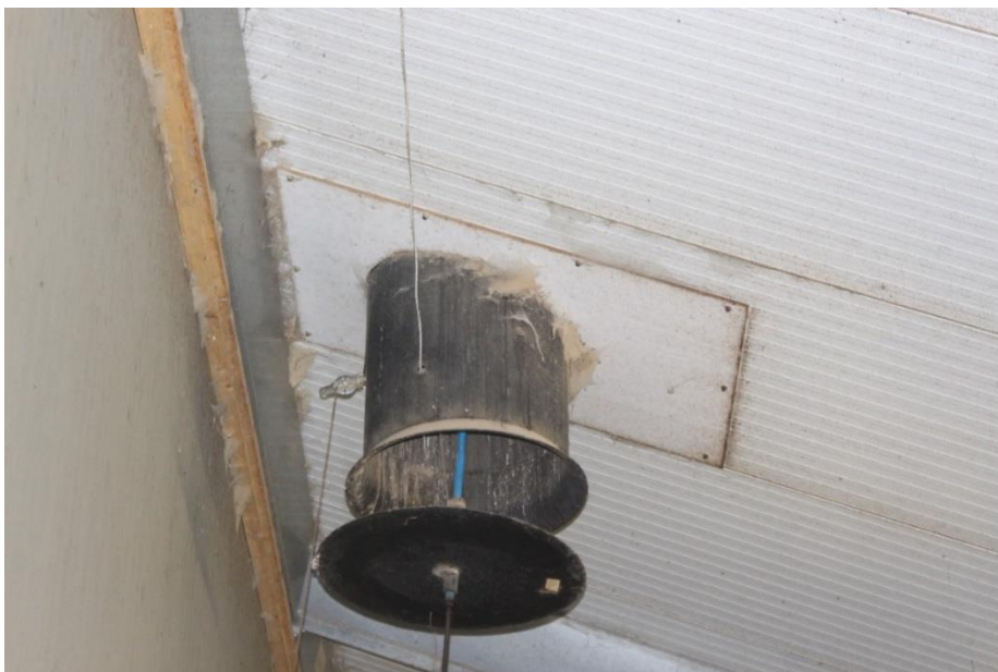
Afbeelding 2.6 Ventilatieschacht in het dak
