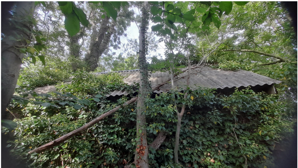
Foto 2; Asbestverdachte golfplaten zonder dakgoot
