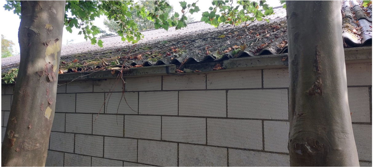
Foto 1; Asbestverdachte golfplaten waarbij de dakgoot plaatselijk beschadigd is
