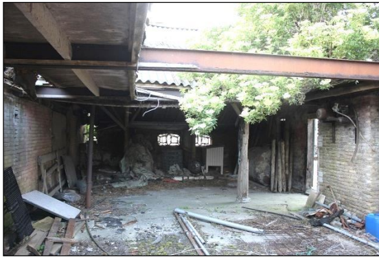
afbeelding 7. Ingestorte schuur tussen boerderij en berging.
