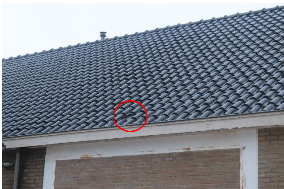
Foto 3: Voorzijde kantoorruimte met kapotte dakplaat (rood omcirkeld)
