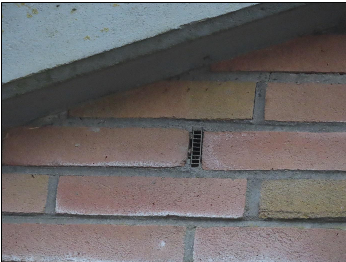
Figuur 2.4. Aanwezige spouwvoegen binnen het plangebied zijn ontoegankelijk gemaakt voor vleermuizen.
