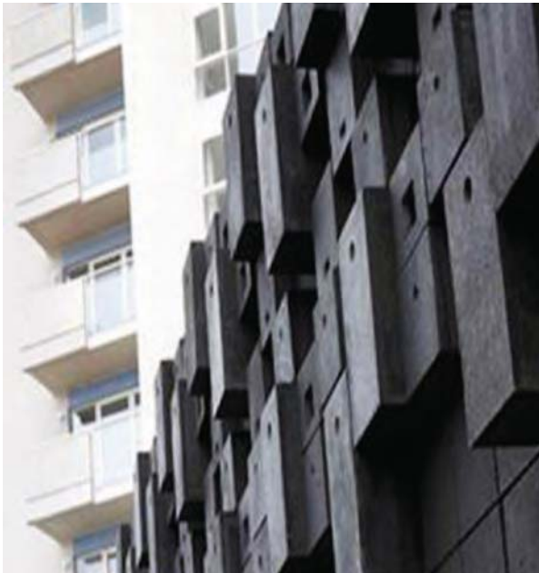
nestkasten voor vogels of vleermuizen verwerkt in gevel
