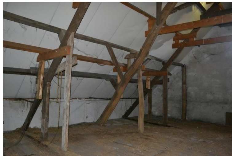
Deels oude en vernieuwde onderdelen spantconstructie.
