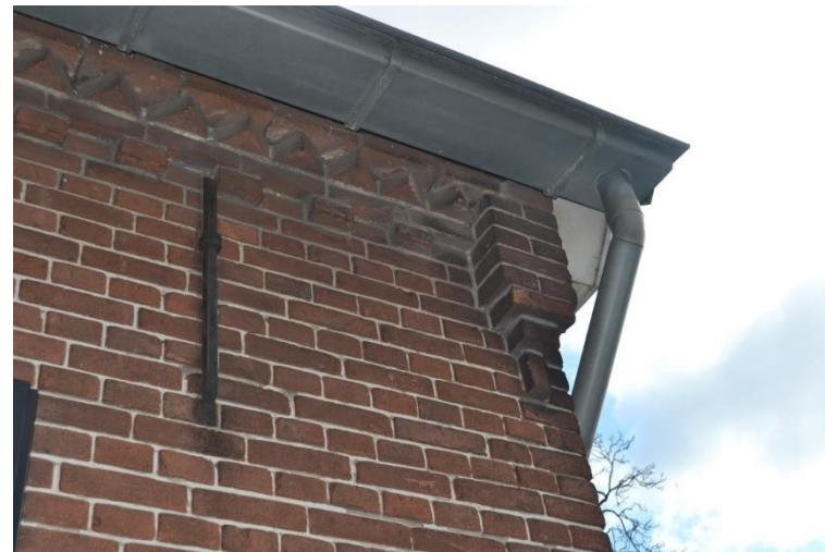
Getande sierlijst in dakvoet metselwerk.
