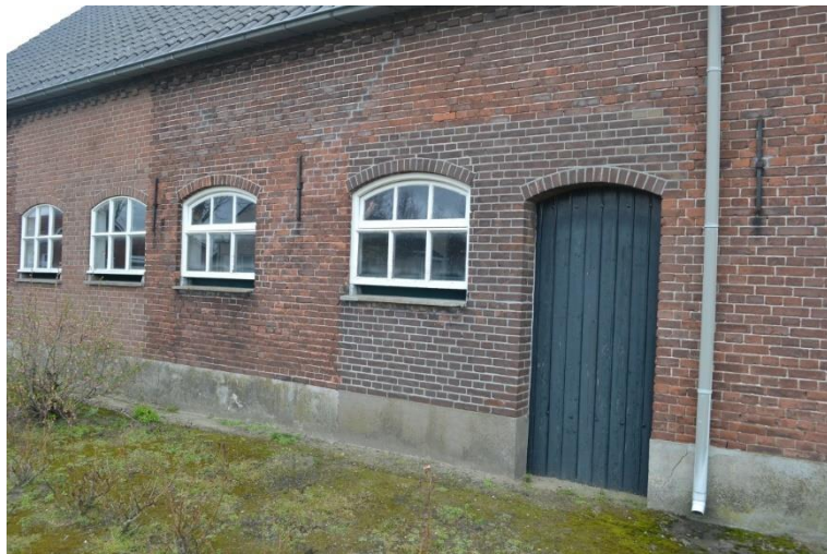
Staldeur met stalvenster, onregelmatigheden in metselwerk.
