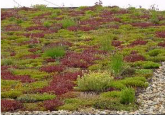
Sedumdaken kunnen veel water vasthouden en zorgen voor een goede isolatie en temperatuurregulering
