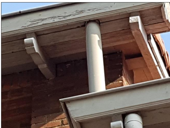
Figuur 9. Versleten dakbetimmering
