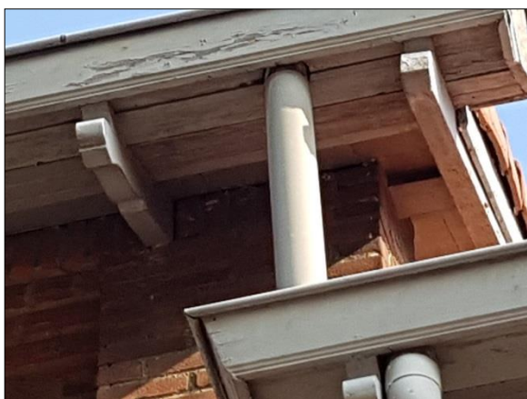
Figuur 9. Versleten dakbetimmering
