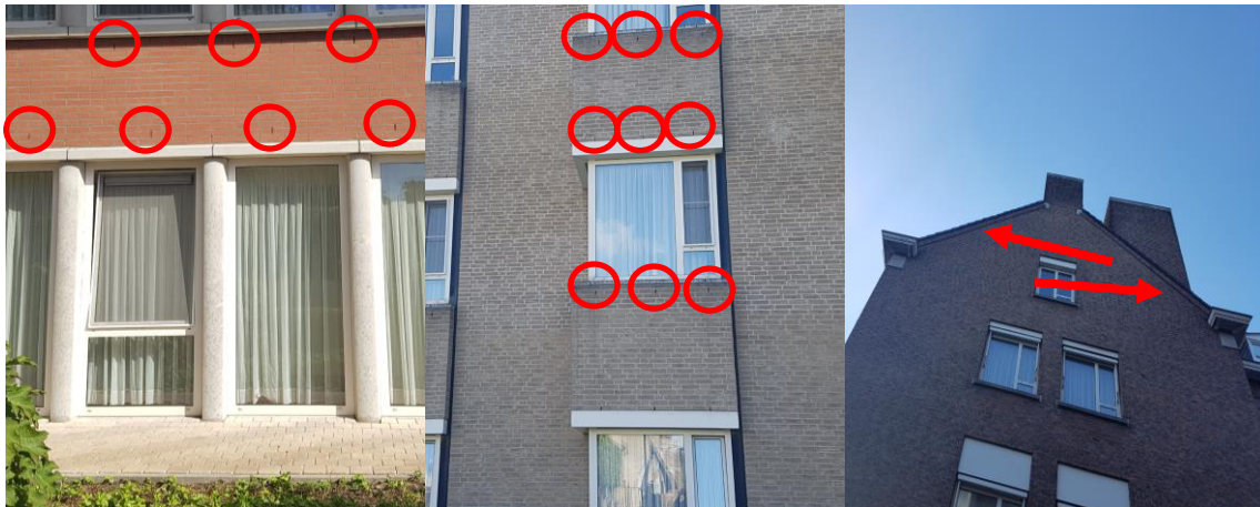
Figuur 10. Invliegopeningen die toegang bieden tot potentiële verblijfruimten voor vleermuizen. (A) stootvoegen bij een appartementencomplex, (B) stootvoegen bij het zigzaggebouw, (C) ruimtes onder gevelpannen aan de kopse kant van het internaatgebouw.
