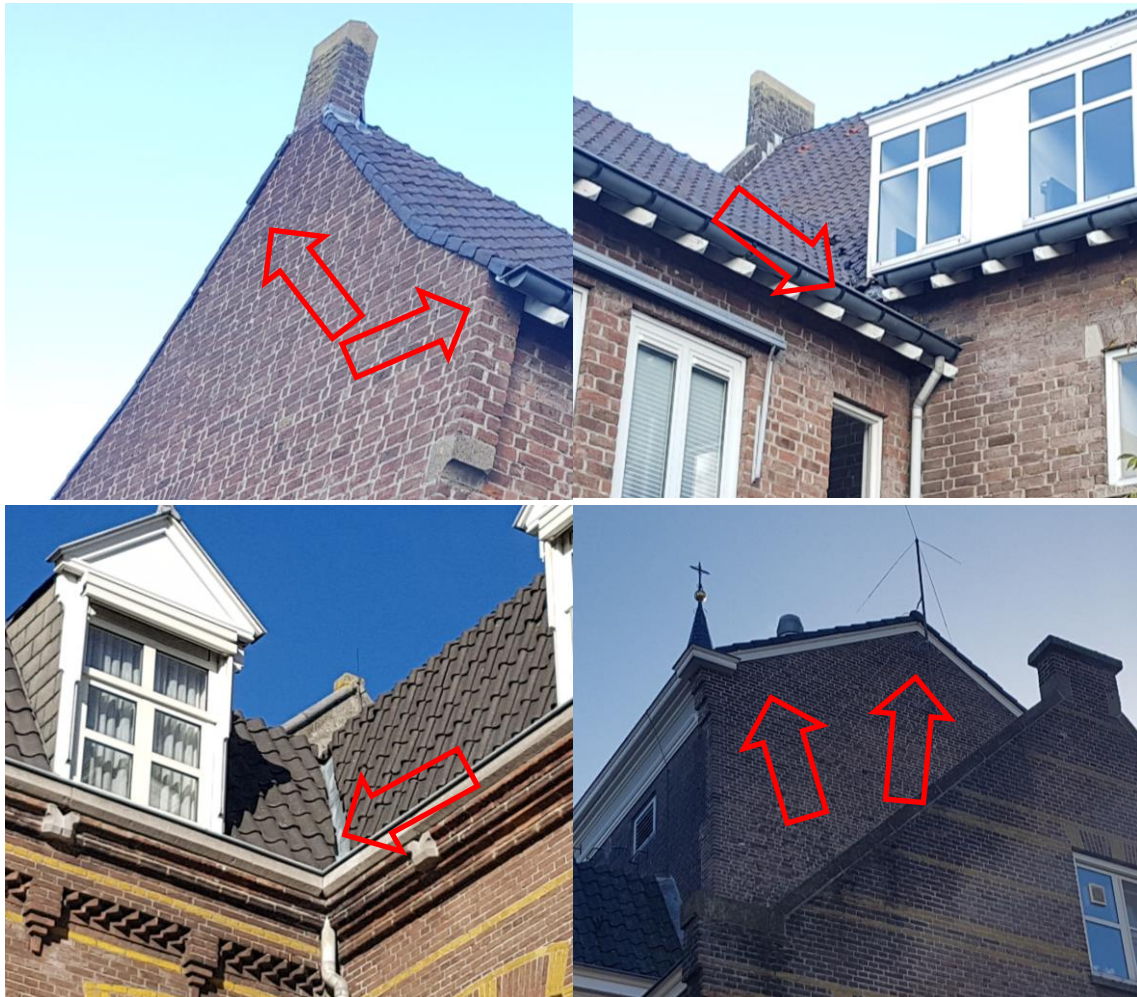
Figuur 6. Diverse invliegopeningen die toegang verschaffen tot de ruimte(n) tussen de dakpannen en het dakbeschoot, met de klok mee: (A) Invliegopeningen onder de gevelpannen van het ULO-schoolgebouw, (B) invliegopeningen onder dakpannen van het ULO-schoolgebouw, (C) invliegopeningen onder dakpannen van de gasthuisvleugels van het moederhuis, (D) invliegopeningen onder de gevelpannen van het internaatgebouw.
