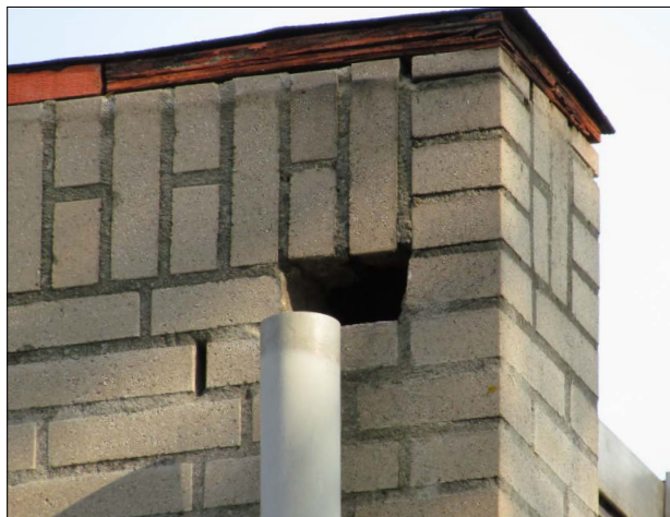
Figuur: bovende regenpijp ontbreekt een deel van de pijp, waardoor er een gat aanwezig is. Dit is echter ongeschikt als broedplek voor vogels, omdat er bij regenwater doorheen stroomt.
