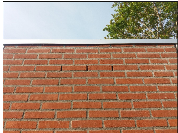
Figuur 13. Spouwopeningen in de garageboxen achter de Aldi.
