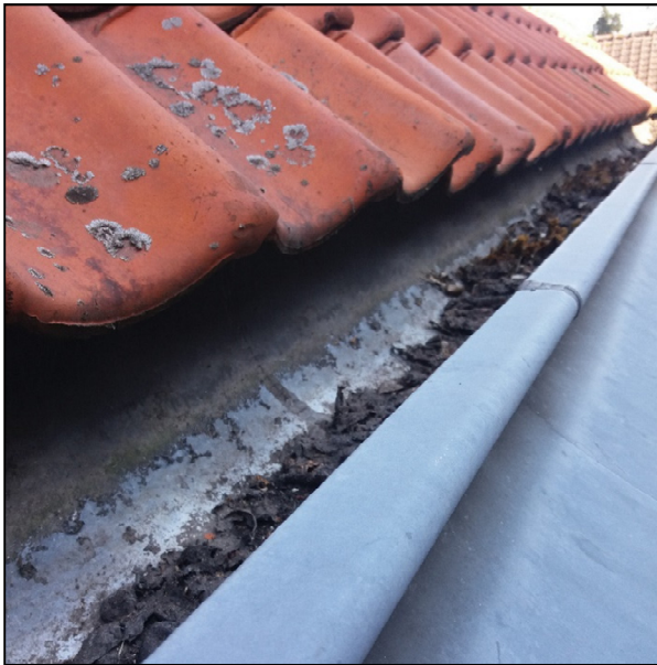
Figuur 11. Ruimte onder de dakpannen is voor huismussen te bereiken via de dakgoot.
