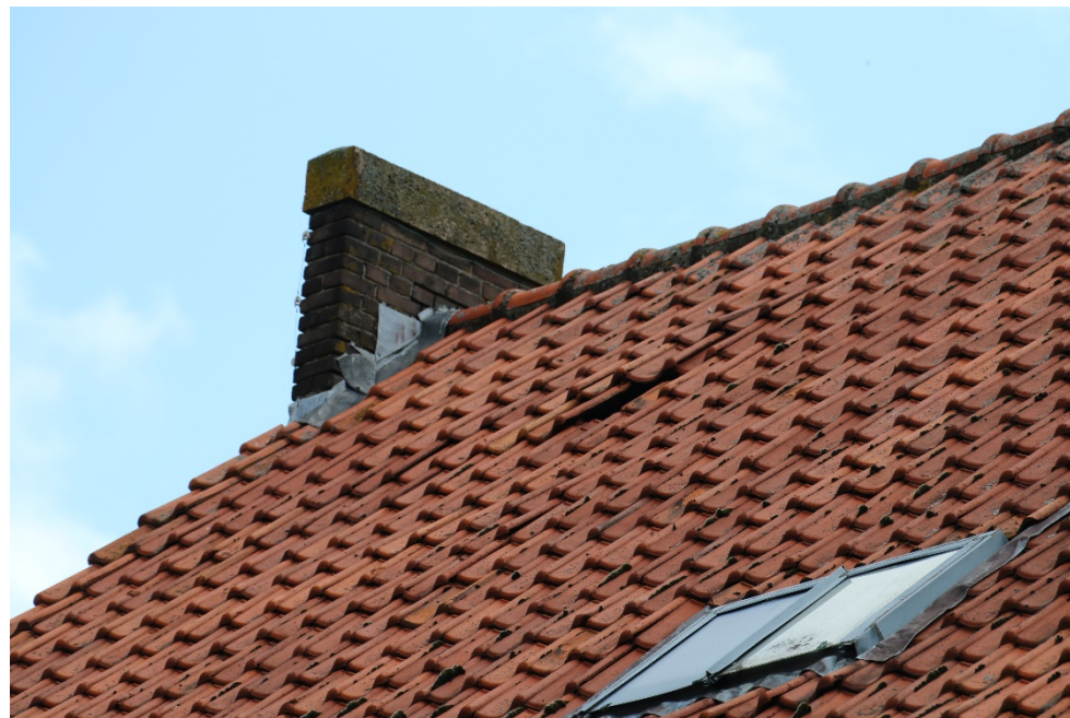
Figuur 12. Ook aan de westzijde van het dak zijn openingen in het dak aanwezig.
