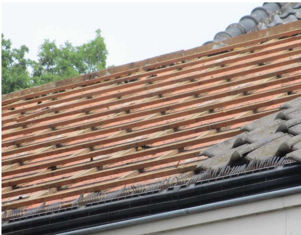
Figuur 5 Dak van de tussenwoning, waar al een groot gedeelte van de dakpannen zijn verwijderd. Aan de voorzijde is het vogelschroot te zien, waardoor huismussen geen toegang hadden tot de ruimte tussen dak en dakbeschot.
