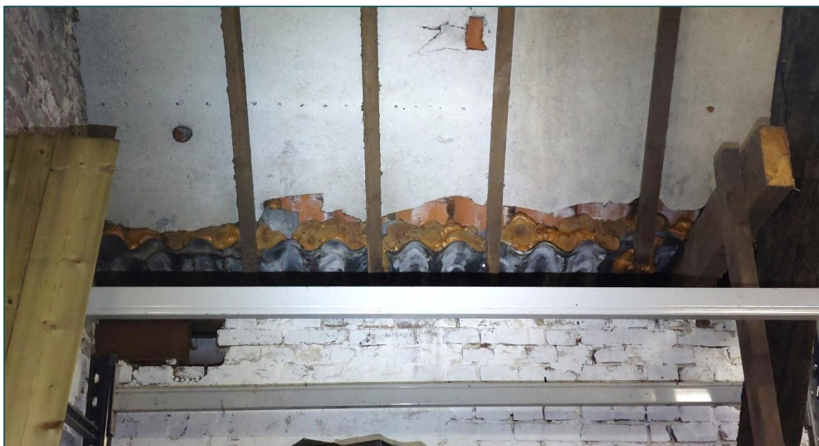
Figuur 3.2 Er is oud purschuim aanwezig onder de pannen aan de achterzijde van gebouw 1.
