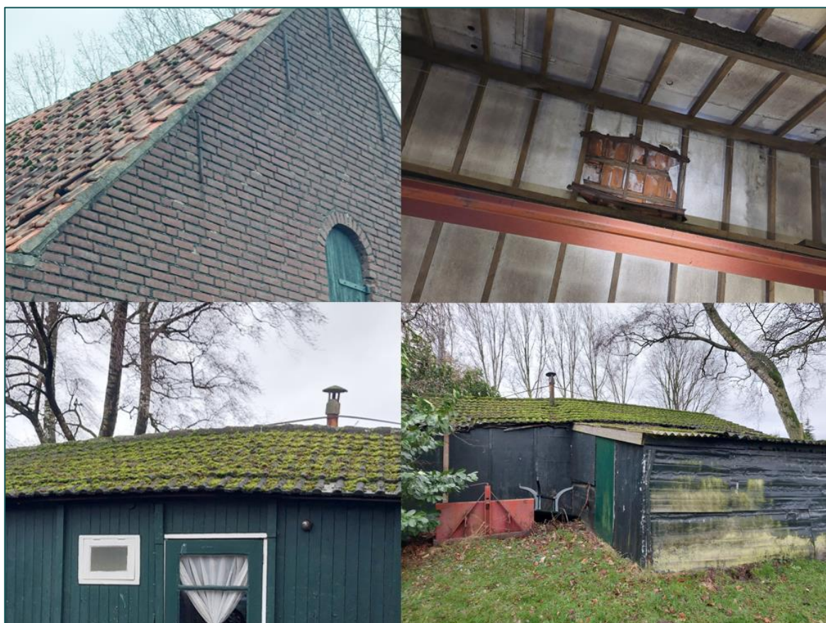
Figuur 3.1 De kantpannen in de schuur zijn afgesloten met specie (linksboven), in het dakbeschot zijn grote gaten aanwezig (rechtsboven). Het dak van de voormalige woning is begroeid met mos waardoor de kans op lekkages groot is (linksonder), rondom het gebouw zijn veel elementen aanwezig welke invliegopeningen belemmeren (rechtsonder).
