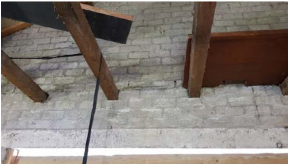
Geen stelmateriaal onder balken aangetroffen
