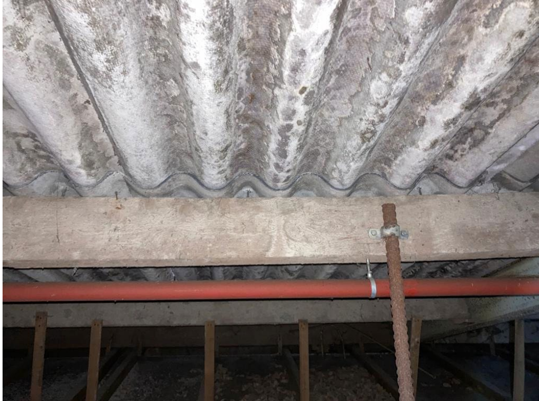
• Afbeelding 12: dakbeschot voorste gedeelte geheel ongeïsoleerd
