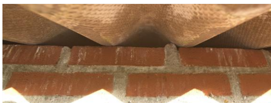
Figuur 9a: mest onder asbestdakplaten (vergelijk figuur 5)
