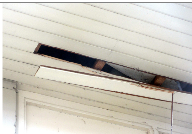
Fig. 8 loshangende plank bij voorgevel
