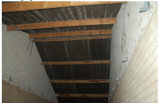
binnenzijde stal 1 met niet geïsoleerd dak
