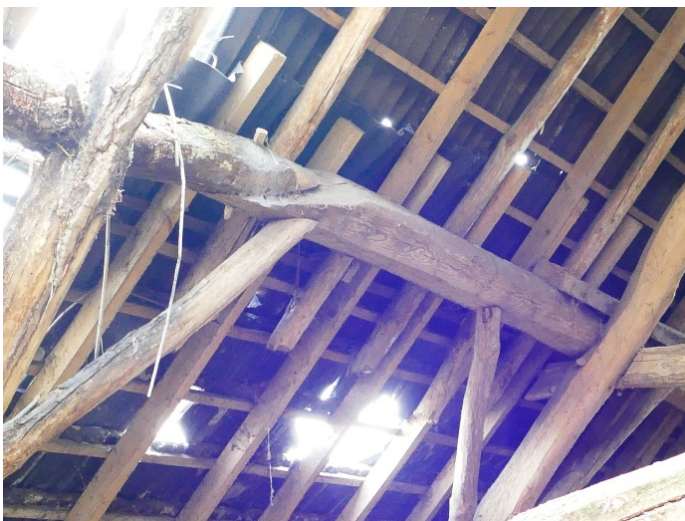
Een deel van de kap met praktisch allemaal rondhout. Links een las in de gording, met toognagel. De ligger van het linker spant is losgeraakt en hangt schuin naar beneden (rechts onder).
