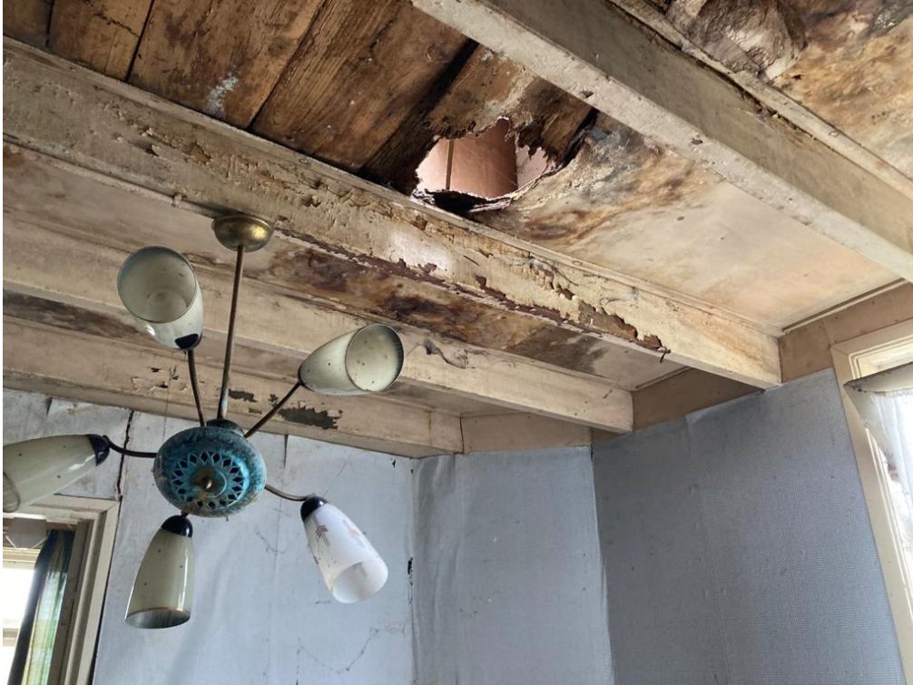
• Afbeelding 10: binnenzijde te verbouwen woonboerderij met lekkage
