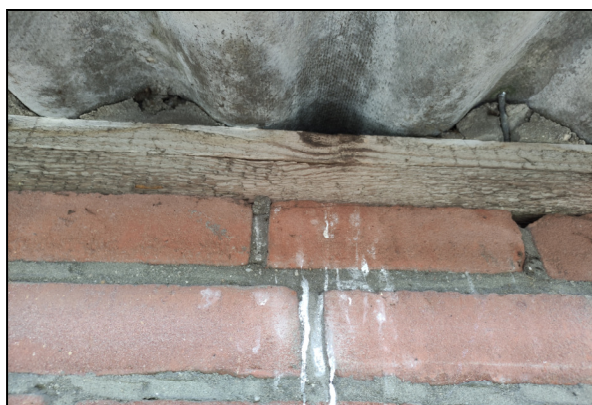
Foto 1: Opening tussen gevel en golfplaat aan de oostelijke zijde
