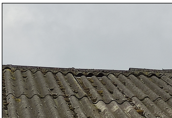
Foto 3: Opening in het dak aan de zuidwest zijde
