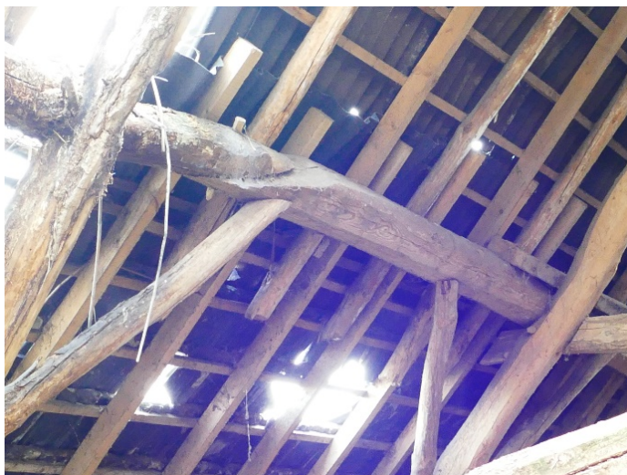
Een deel van de kap met praktisch allemaal rondhout. Links een las in de gording, met toognagel. De ligger van het linker spant is losgeraakt en hangt schuin naar beneden (rechts onder).
