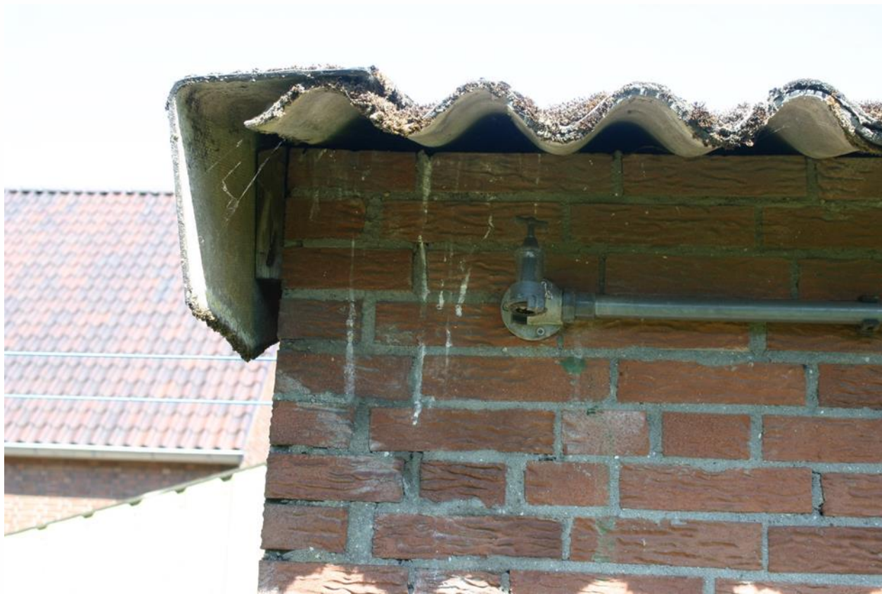
Figuur 4.4.1. Ook door de aanwezigheid van spreuwen uitwerpselen is duidelijk dat hier een nest aanwezig is.
