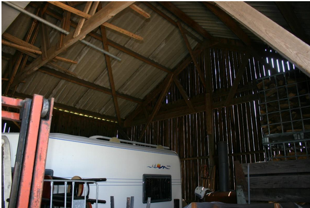
Figuur 4.4.3. Het dak en de gevels van de voormalige hooischaar en carport zijn enkelwandig.
