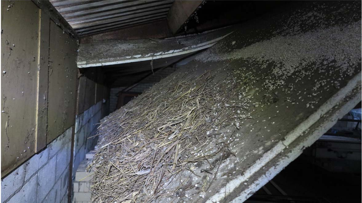
Figuur 4. Resten van mussennesten onder het dak van de loods aan de westrand van het erf.
