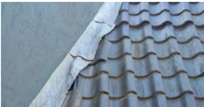
Figuur 4: Detailopname van gebroken dakpannen
