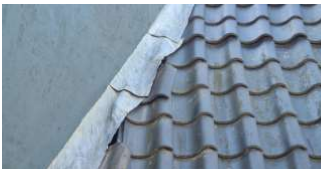
Figuur 8: Detailopname van gebroken dakpannen
