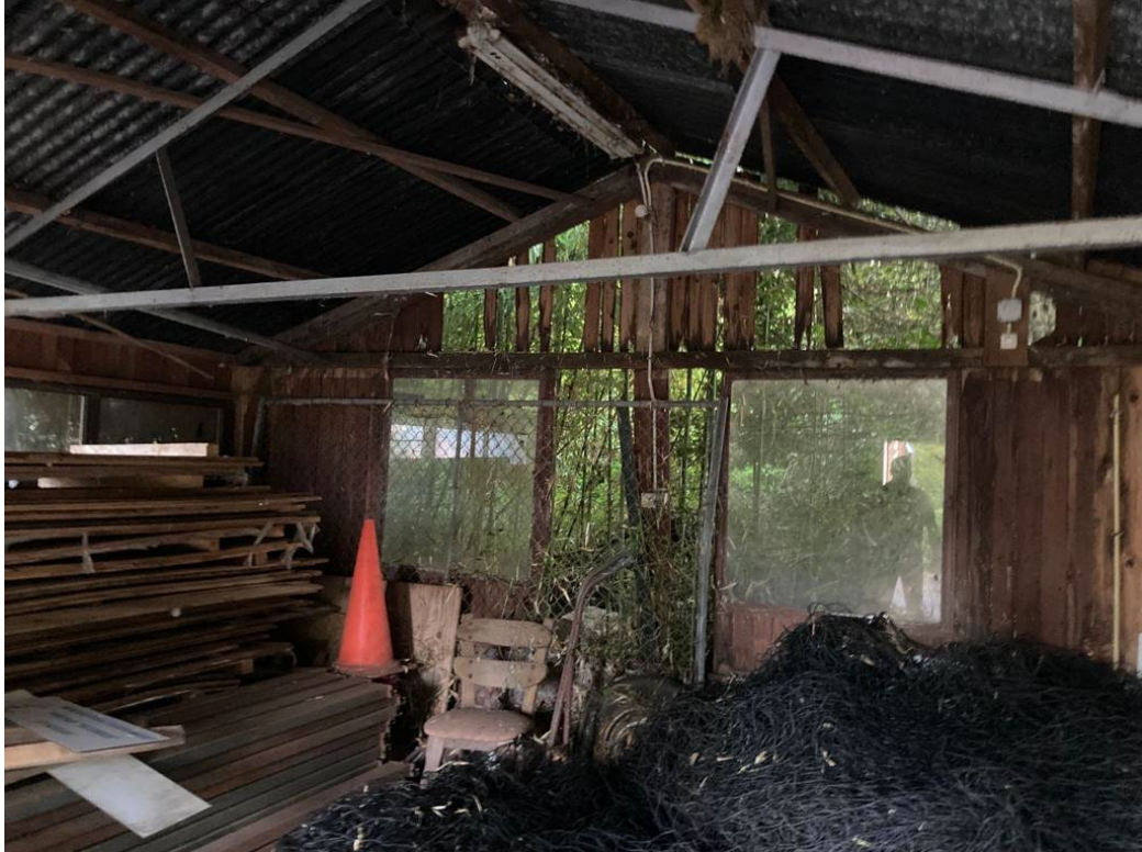
• Afbeelding 20: te slopen bijgebouw
