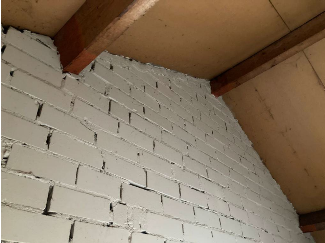
• Afbeelding 16: zolder woonhuis minimaal geïsoleerd
