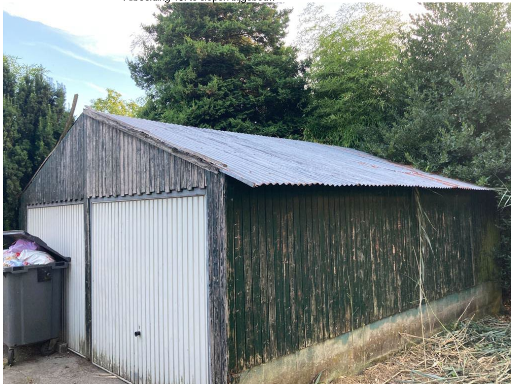
• Afbeelding 19: te slopen bijgebouw
