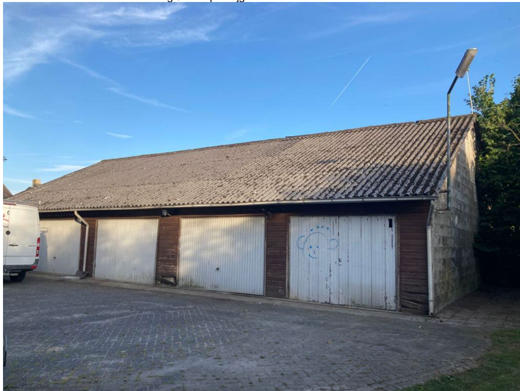
• Afbeelding 3: te slopen bijgebouw
