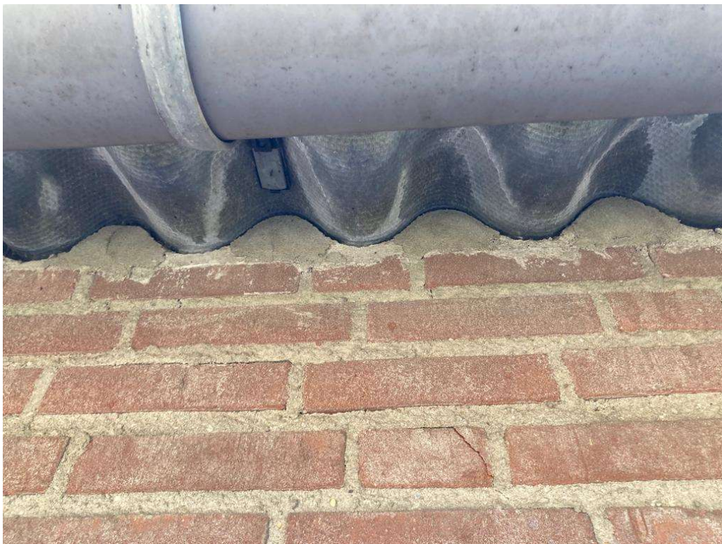
• Afbeelding 15: onderzijde dakgoot, dicht gesmeerd met specie
