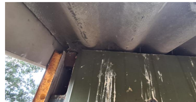
Figuur 11: Vogeluitwerpselen op de gevel van de westelijke opstal
