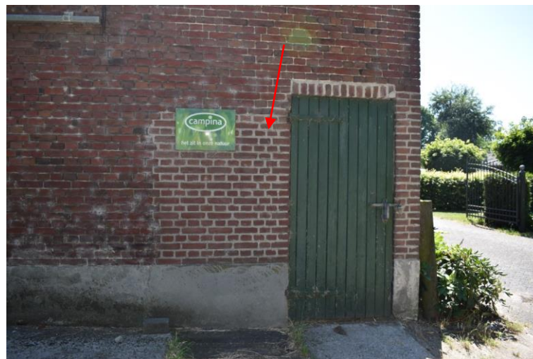
Opgeklampte houten staldeur onder rollaag (rechts). De rode pijl wijst inboetwerk aan.
