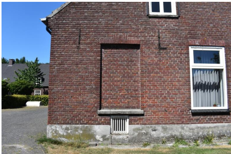
Dichtgemetselde raamopening en later geplaatst betonnen dorpel.
