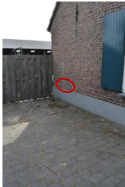
Inboetwerk tpv dichtgezette keldervenster (cirkel)
