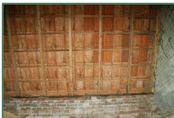
Niet onderschoten dak
