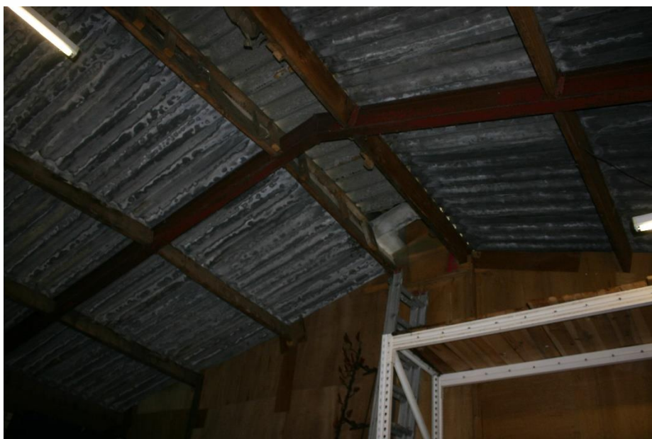
Figuur 4.4.1. Het dak op de voormalige varkensstal is grotendeels enkelwandig.
