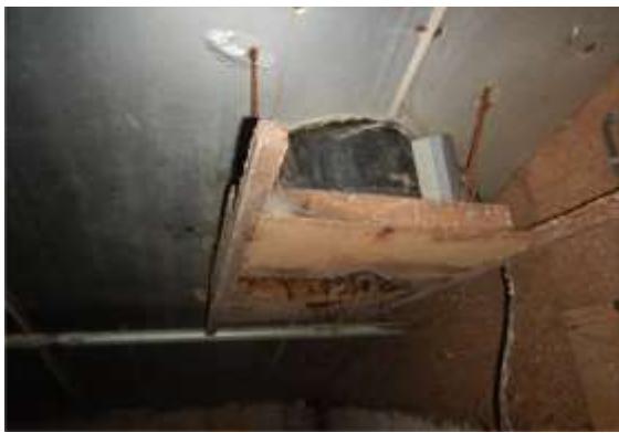
Ventilatiekokers van pvc met houten frame
