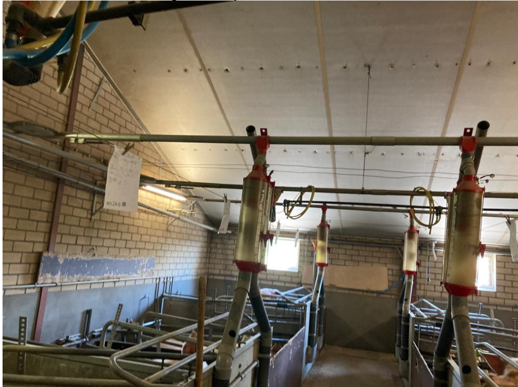
• Afbeelding 26: binnenzijde varkensstallen
