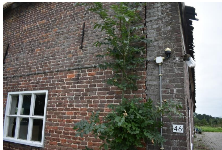
Verticale bouwnaad in het metselwerk.
