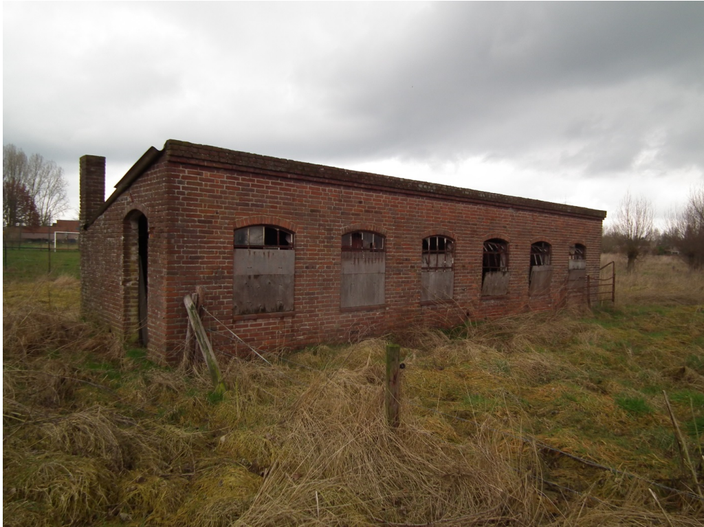
Figuur 3 Achter op het terrein, aan de noordzijde, is een klein stalletje aanwezig. Het gebouw verkeerd in een zeer slechte tot vervalten staat.
