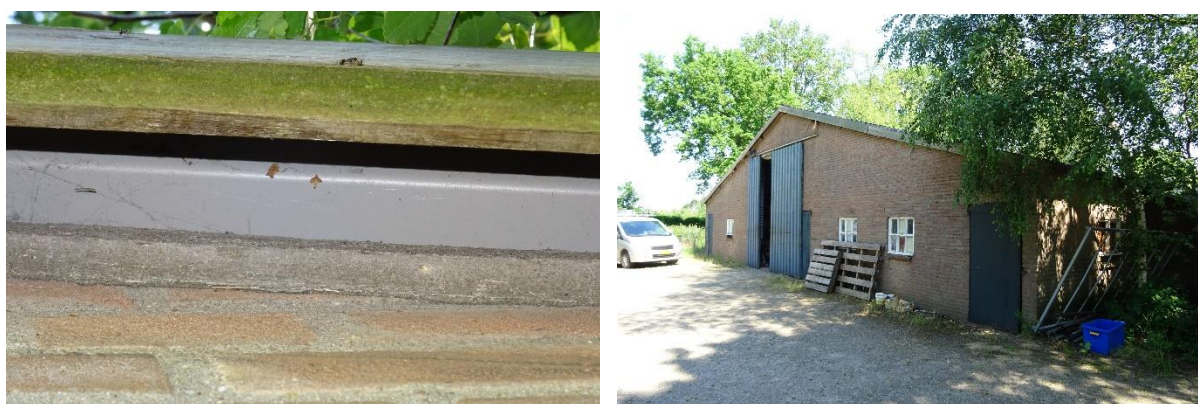
Afbeelding 19 en 20: afwezigheid van mogelijk geschikte ruimten voor vleermuizen om te verblijven. Ook zijn er in de gevels geen open stootvoegen welke toegang bieden tot de spouw in de muur. Bron: R.J.L. Bijvelds 10-06-2021
