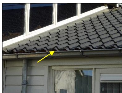
Figuur 16. Ruimte onder dakpanplaten geschikt als broedplaats huismus.
