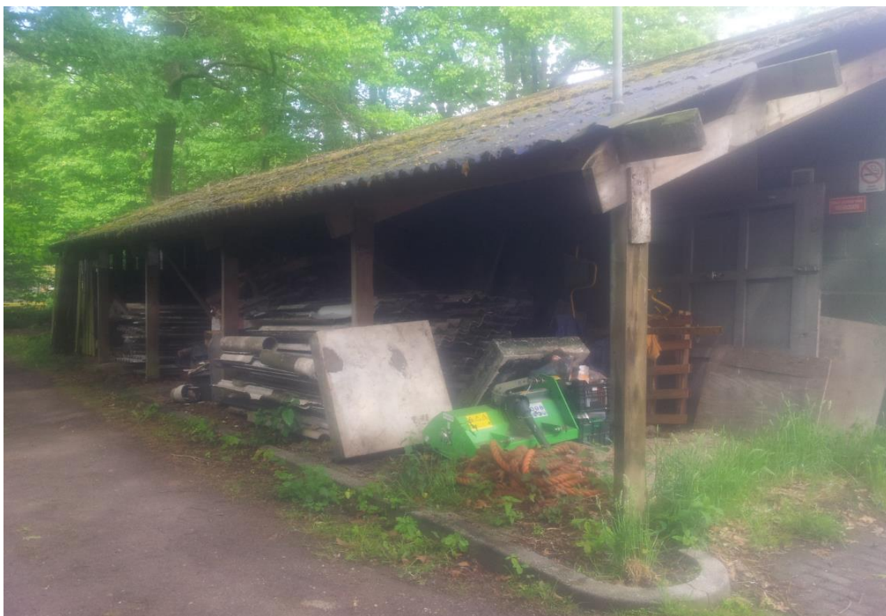
Afbeelding 4: Opslag van asbestverdachte materialen.
