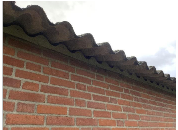
Foto 4 Het geplaatste afdichtingsprofiel aan de westzijde van de stal dat is verzakt.
