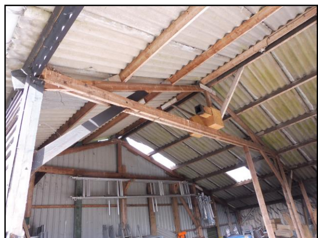
Fig 10. De kerkuilenkast in de opslagloods.
