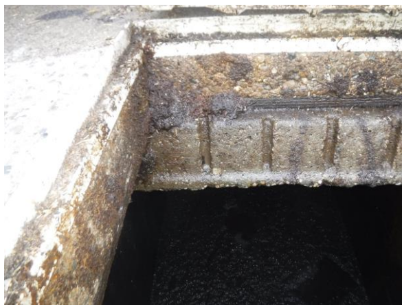
Putinspectie: broodjesvloeren goed zichtbaar.
