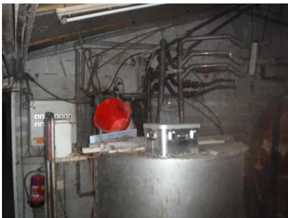
Voerinstallatie: geen verdachte materialen.
