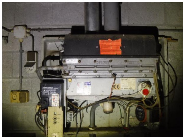
Nefit CV installatie: niet asbestverdacht.
