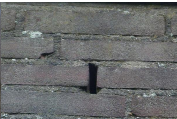
Figuur 4. Open stootvoegen in westelijke muur
