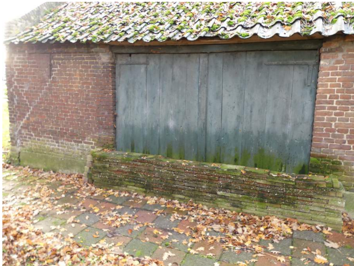
Afb. 10: herstelde maar terugkomende scheurvorming hoek (fundering, ondergrond?), historische Poort, compleet met taatsgehangen in lateibalk
