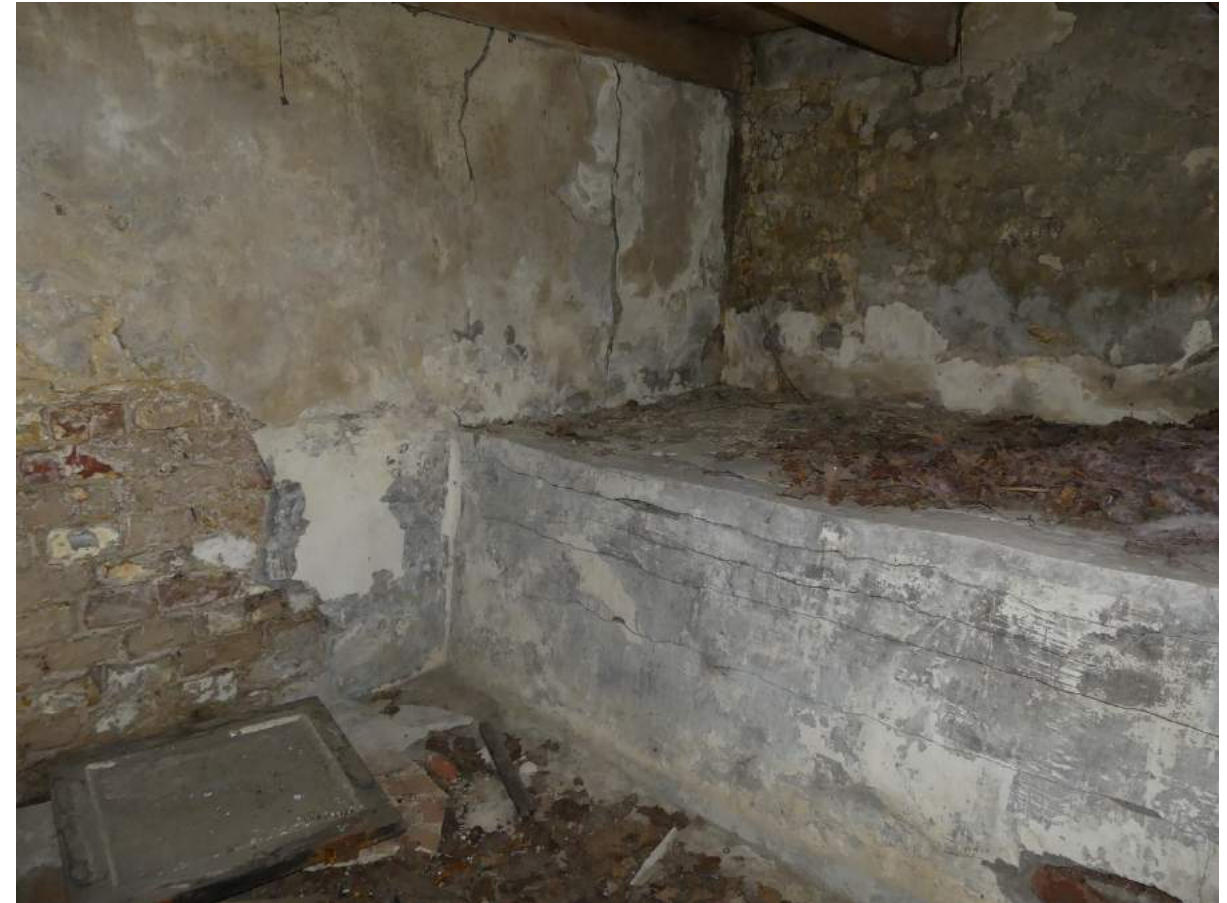
Afb. 15: afgefallen pleisterwerk in de kelder (scheurvorming in wand?)
