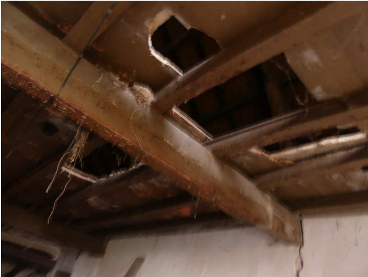
Afb. 13: vergaan beschoot zoldervloer, scheur in muur onder oplegging
