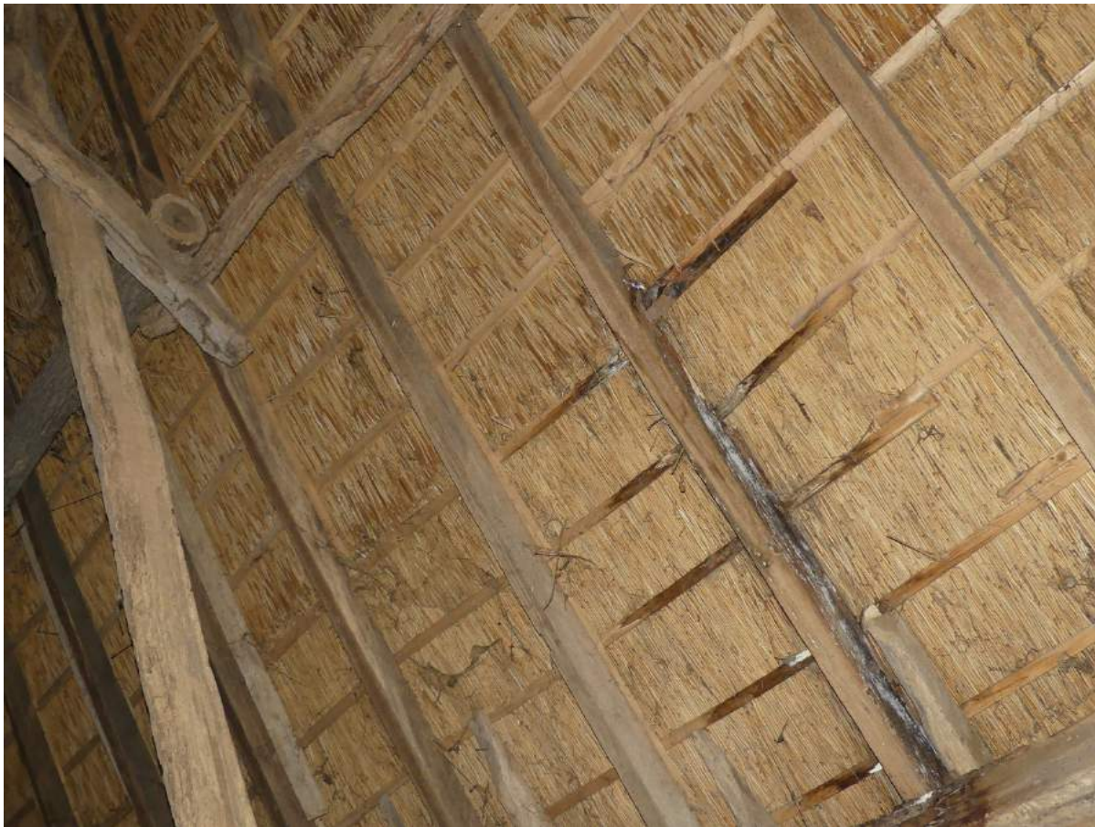
Afb. 18: door lekkage aangetaste rietlatten en spoor
