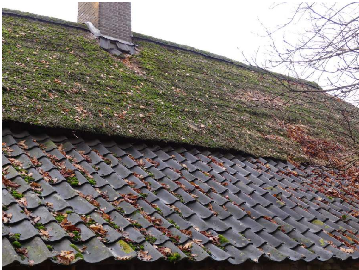
Afb. 6: uitgezakte aansluiting schoorsteen ( lekkage! ), roestige binddraden, los riet (rechts)
