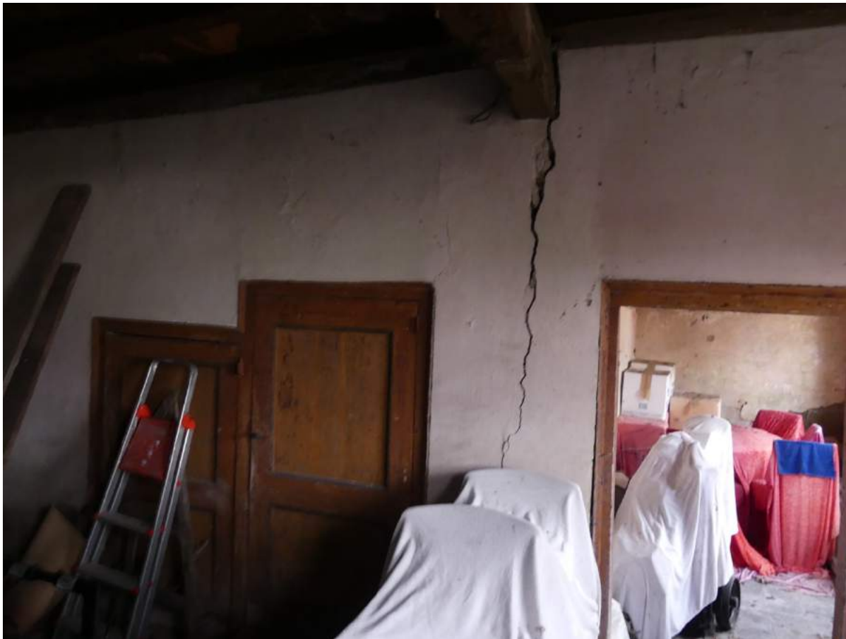
Afb. 14: scheur in muur, opslag
