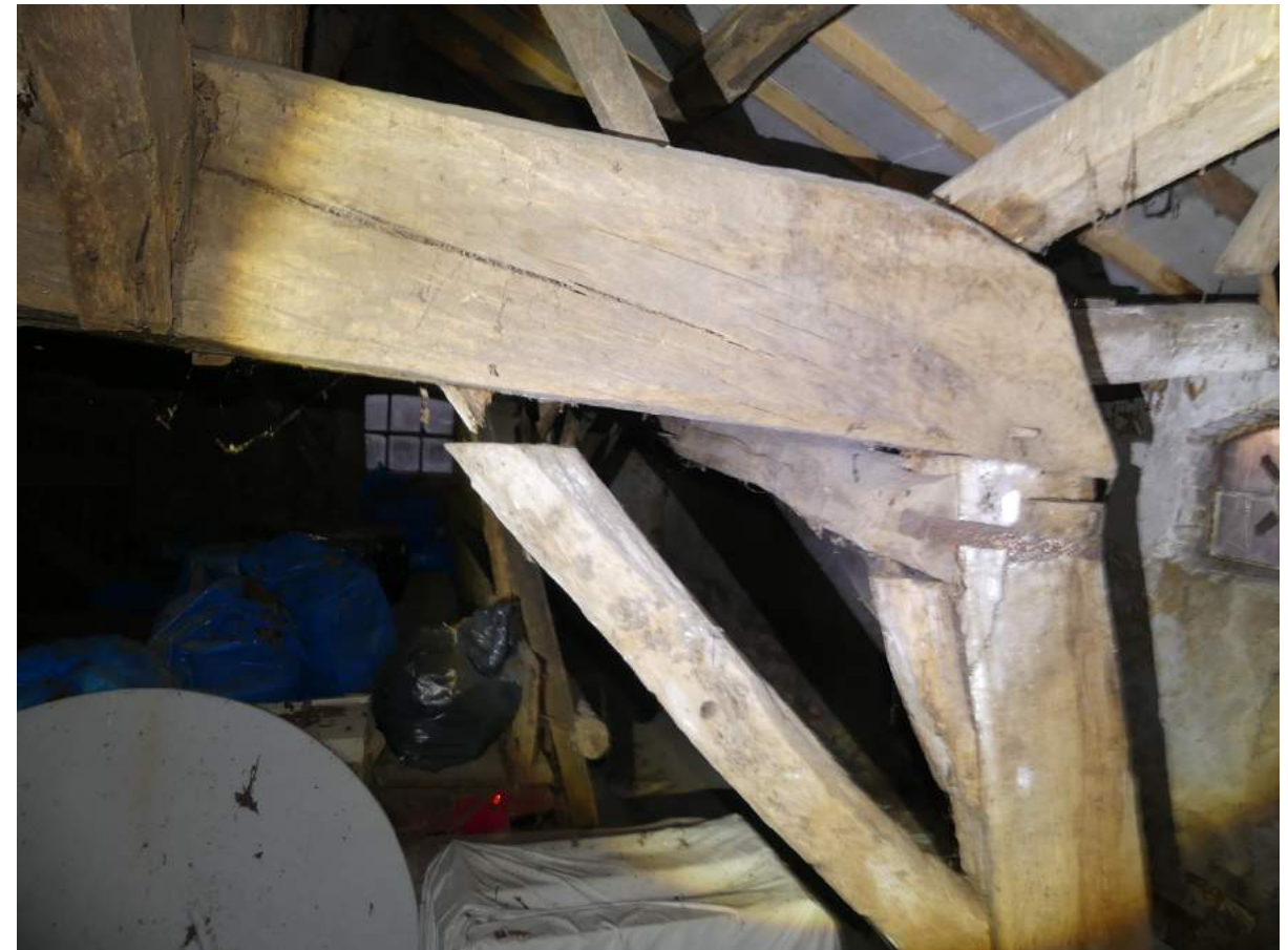
Afb. 20: detail linker gebintstijl met losgetrokken/gebroken schoor (verzakking/gierkelder?)
