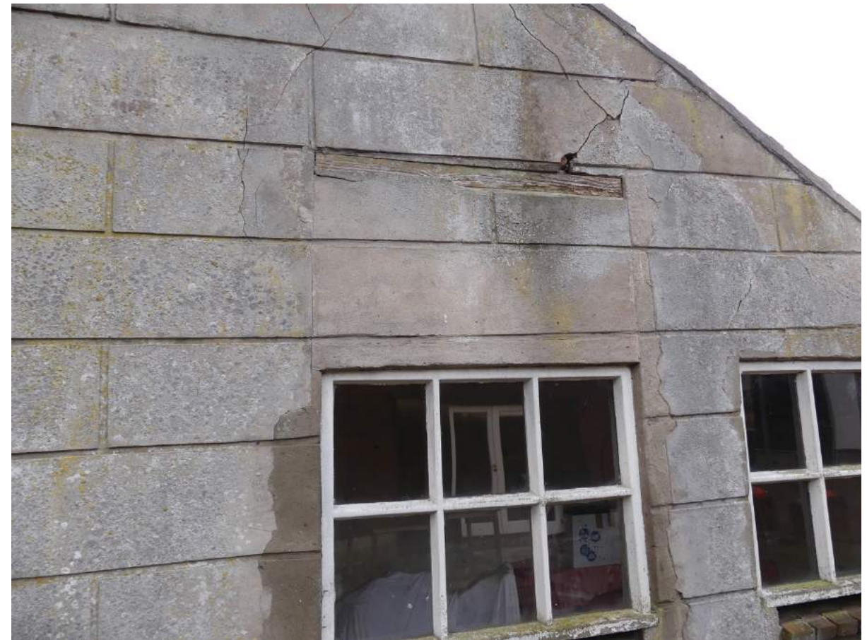
Afb. 7: scheuren in pleisterwerk, sporen dichtgezet schuifraam, foutieve reparaties
