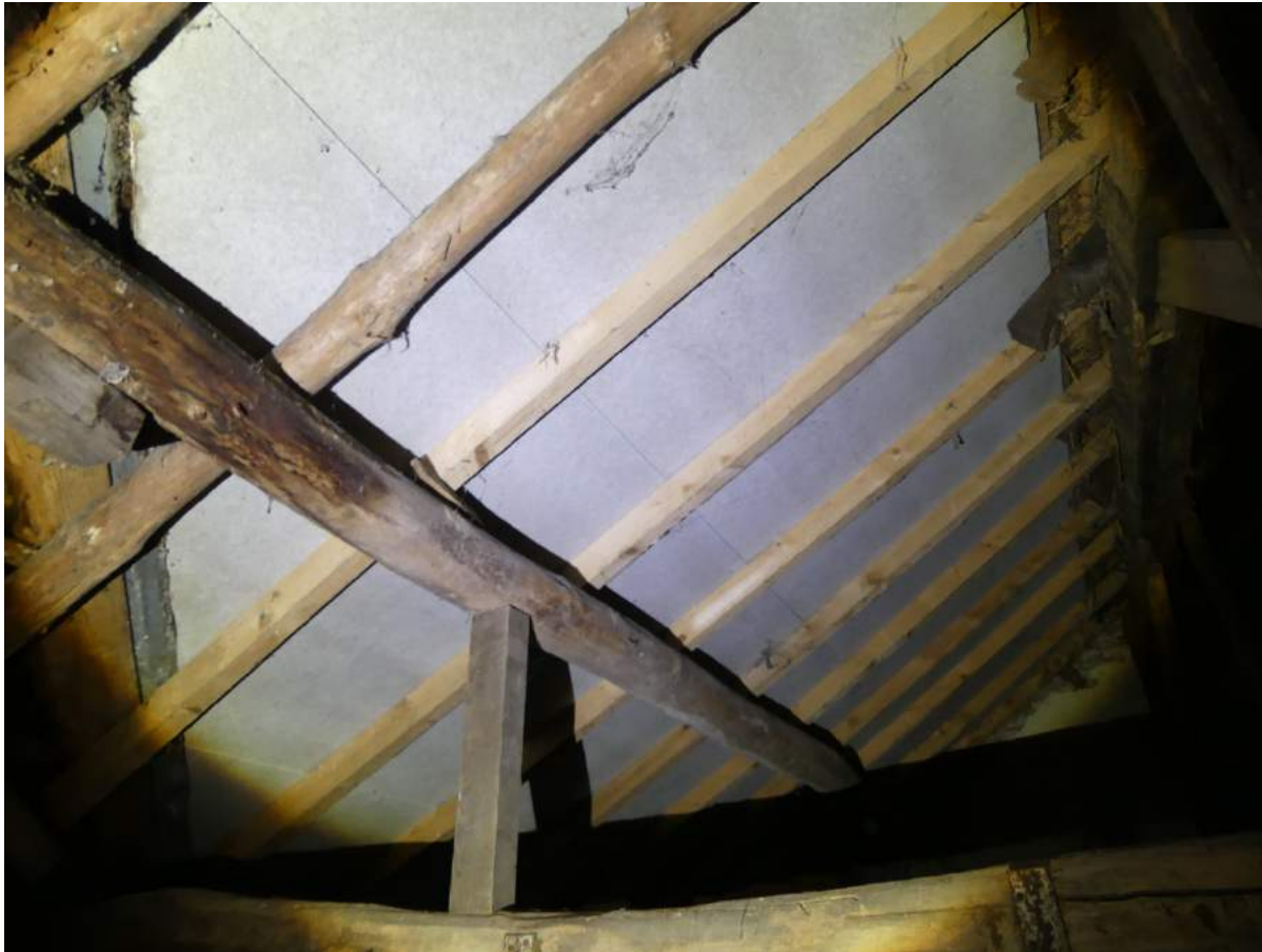
Afb. 17: vermoedelijk asbesthoudend dakbeschot, ronde en rechte sporen
