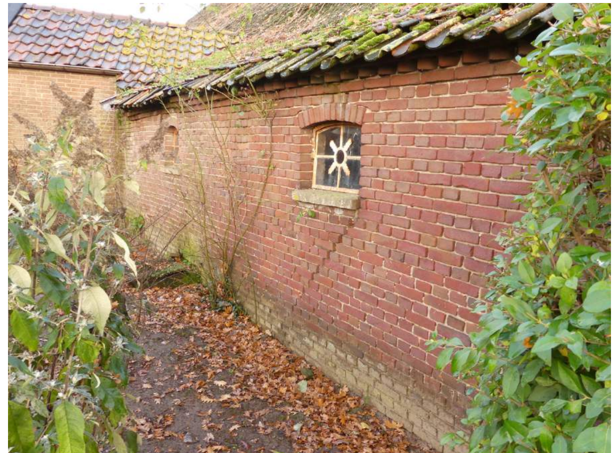
Afb. 12: roestige vensters, uitgespoeld voegwerk
