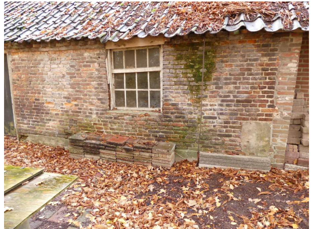
Afb. 8: lekkagesporen, kapotgevroren zachte stenen, gescheurde en afvallende plint, versleten raam
