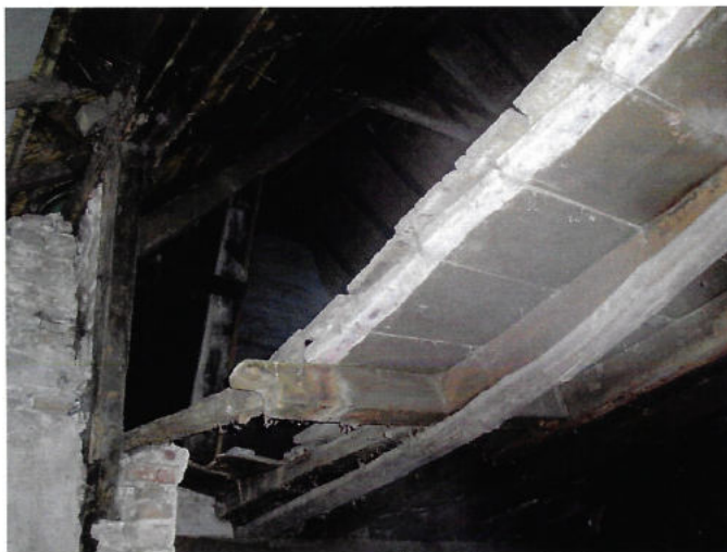
Koppeling van balken waar de dragende muur gesloopt is. Dit is de muur die de extra slaapkamer, van de herd scheidde. Tevens zien we een raveling. Het is mogelijk een vroegere opgang naar de zolder geweest. Het is van belang de balklaag nauwkeurig op tekening te brengen.
