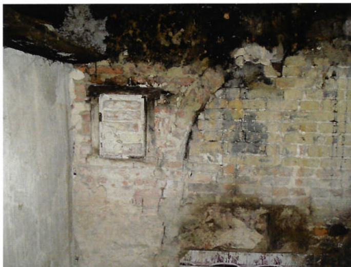
Raampje dat deels achter de binnenwand valt.
