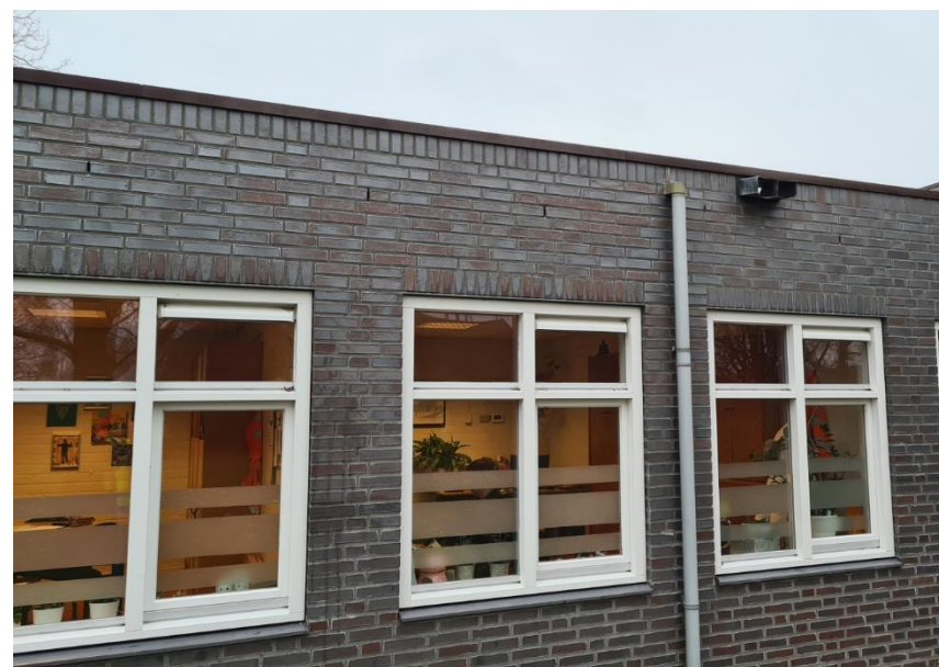
Figuur 2: Noordoostelijke gevel van de school, met open stootvoegen tussen dakrand raamkozijnen
