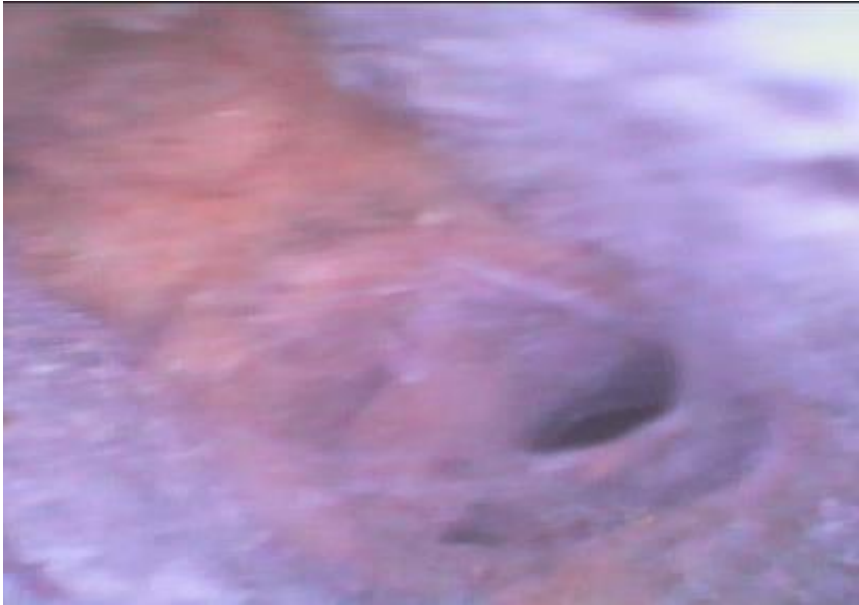
Figuur 4: Isolatiemateriaal en spinrag achter de open stootvoegen
