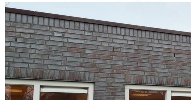
Figuur 11: Open stootvoegen in de noordoostgevel van OBS de Springplank
