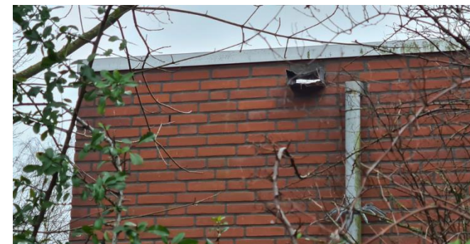
Figuur 13: Open stootvoegen in de zuidoost gevel van Bassischool Kienehoef, achter begroeiing
