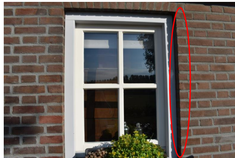
Rood omcirkeld de sporen in het metselwerk bij het vierruits venster.
