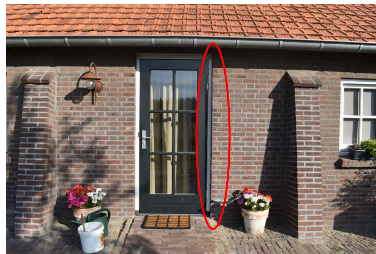
Rood omcirkeld de sporen in het metselwerk bij de deur.
