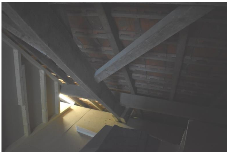
De horizontale balk van het spant is afgezaagd.
